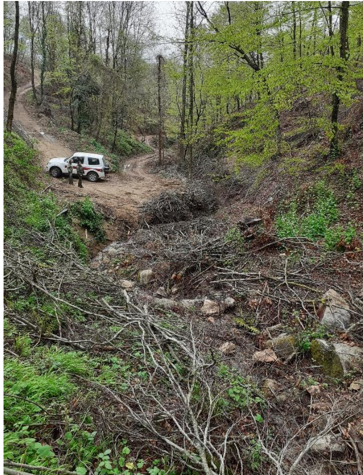
Torrente totalmente alterado por la construcción de una pista forestal de saca de madera (foto: D. Guinart).
