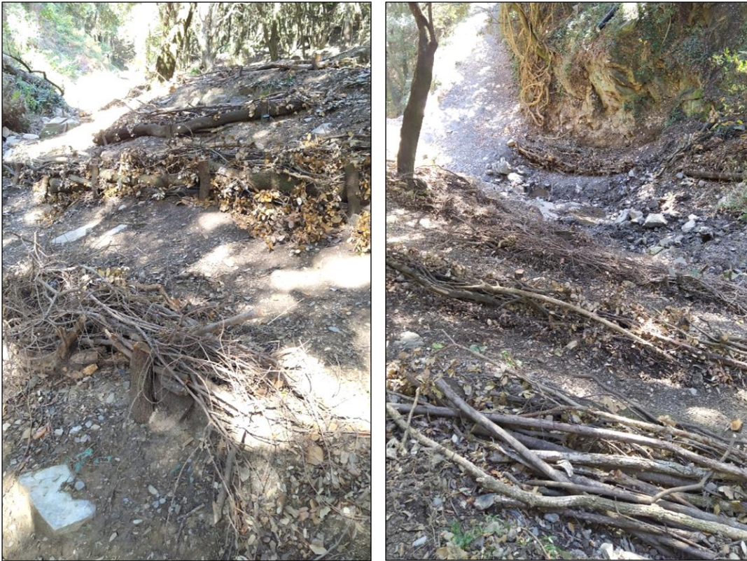
Figura 18. Imágenes del otoño de 2020 de la actuación en el torrente de debajo del camping donde se ven el entramado tipo krainer hecha con los restos del ramaje de la actuación para reducir el efecto de la erosión.
