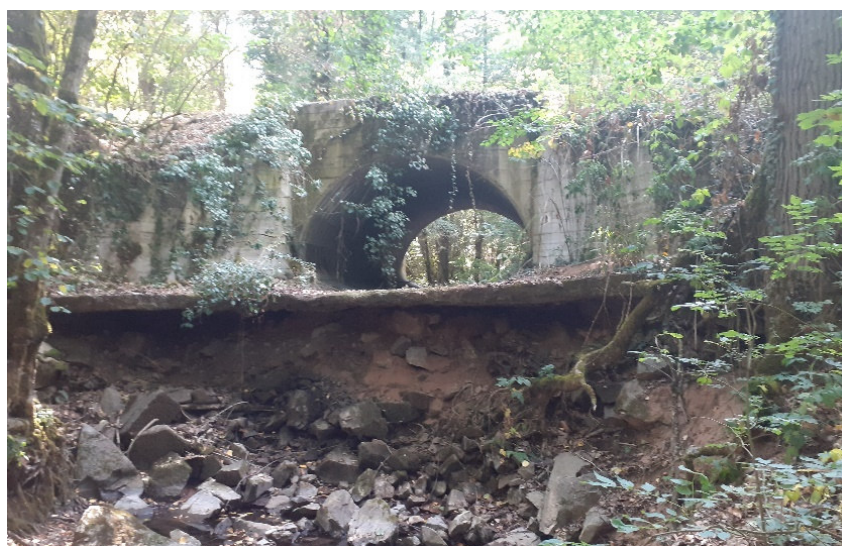
Pont amb la llera del torrent formigonada, amb la consegüent erosió aigües avall
